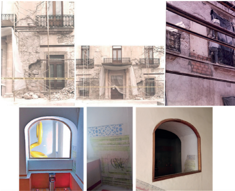
Imágenes 20, 21, 22, 23, 24 y 25. Evidencias del paso de la Escalera Magna antes de su demolición al Claustro anterior o Paso de Celdas, vigente por la ornamentación decimonónica en la primera etapa del Instituto Científico y Literario, antes de que se le diera forma a la fachada actual. Fuente: AJLGR.
