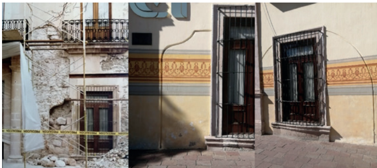
Imágenes 119, 120 y 121. Detección del acceso de la “Escalera Magna” dieguina hacia la planta alta y la hendidura que se dejó en fachada como evidencia al igual que uno de los arcos del Portal de Peregrinos. Fuente: AJLGR.
