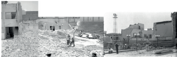
Imágenes 103, 104 y 105. Demolición de la Cancha del Estado y aulas del tercer patio. Fuente: Fototeca UAA.
